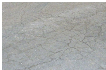
Revnet asfaltbelægning, sætning i underlaget
